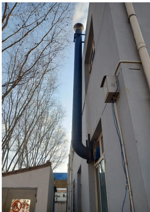
燃气锅炉烟囱
