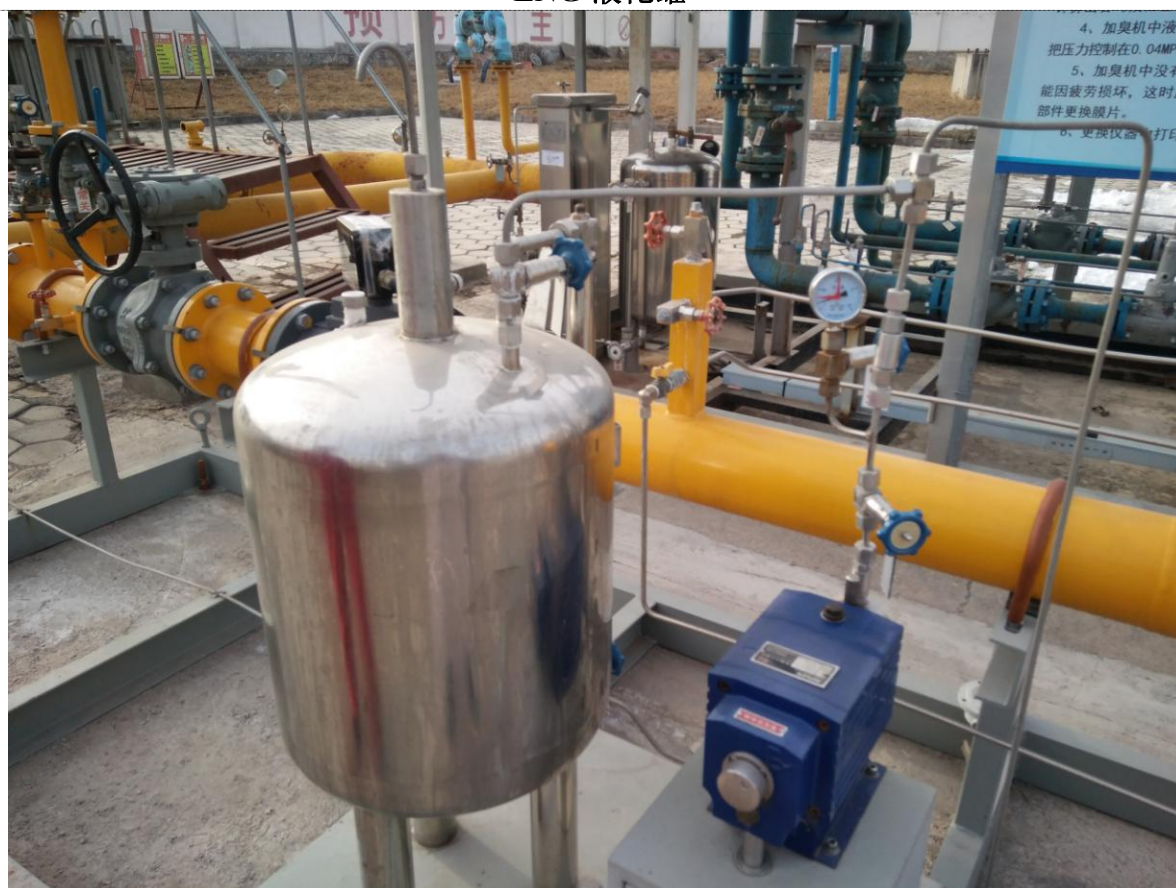
站区工艺设备
